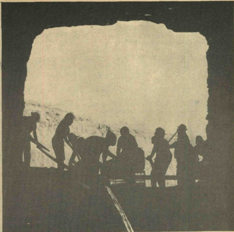
Outro aspecto das obras de Boa Esperança. Recentemente foi feito o segundo e último desvio do leito do Rio Parnaíba, cujas águas movimentarão as grandes turbinas da hidrelétrica. O próximo passo, a inauguração, não demorará.
