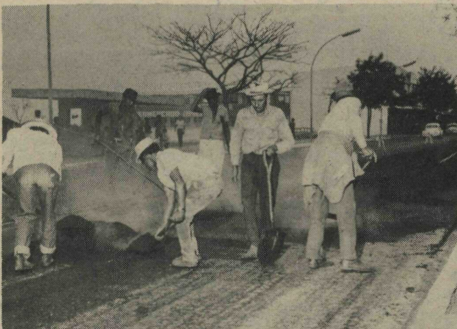
W/3 DE ROUPA NOVA - Cerca de vinte homens continuam trabalhando no recapamento asfáltico da Avenida W/3. O serviço já está quase concluído, tendo-se desenrolado de acordo com o que foi planejado pelo Departamento de Viação e Obras da NOVACAP
