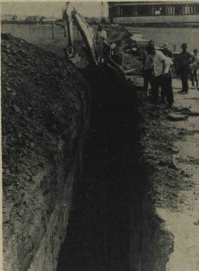
A interligação da Estação Telefônica Centro com a futura Estação Norte está sendo acelerada pela COTELB, que imprimiu novo ritmo na colocação dos tubos por onde passarão os cabos telefônicos. A perfuração já atingiu o "balão" da Estação Rodoviária, lado Oeste, tendo sido ativada para não ocasionar congestionamento no tráfego de veículos naquela área
